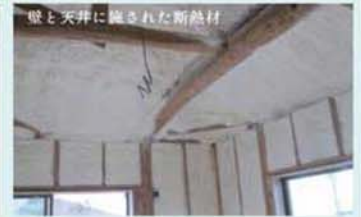
壁と天井に施された断熱材
